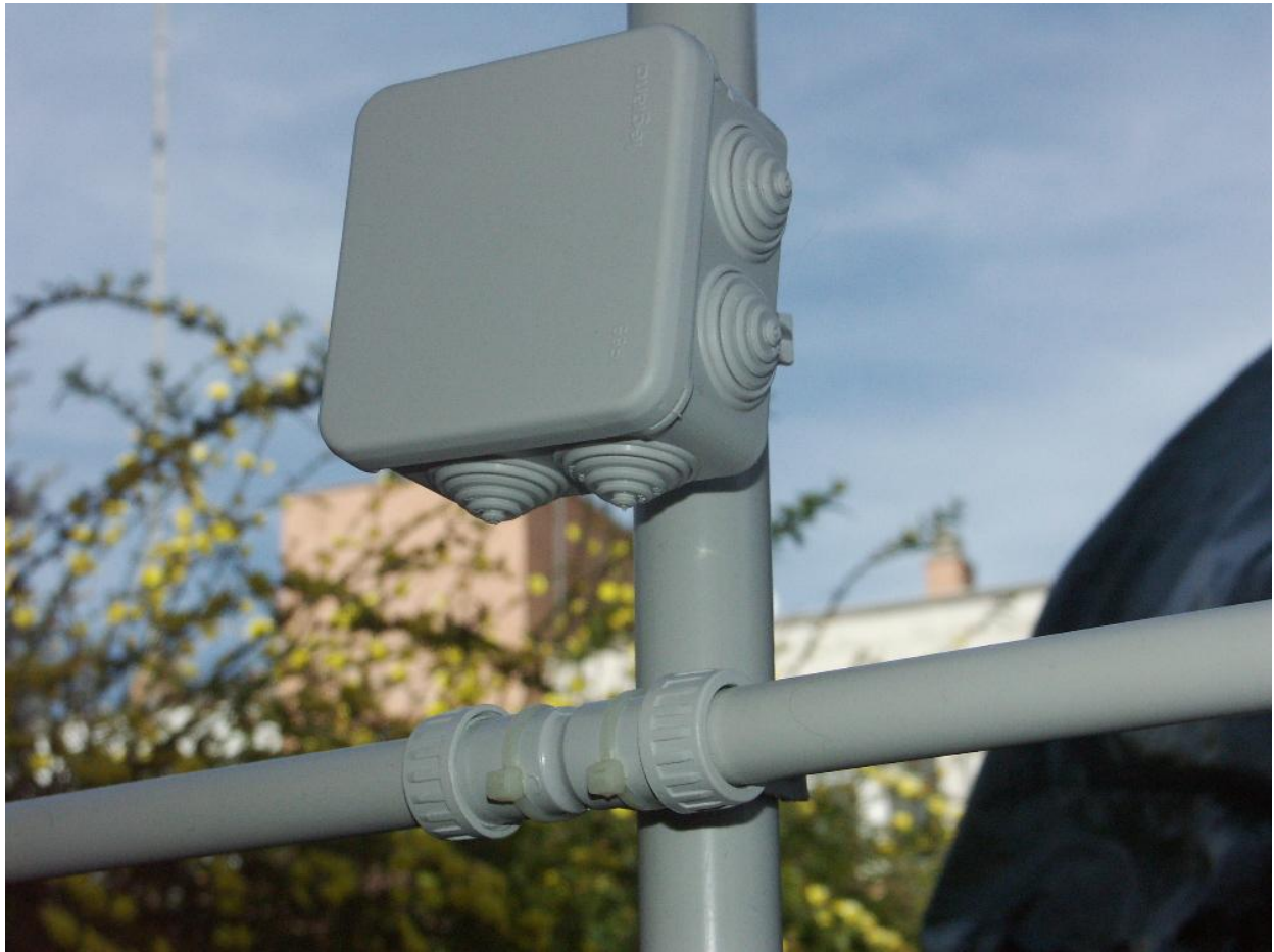
Foto 15 – Vista punto di alimentazione Square Loop, vista anteriore
