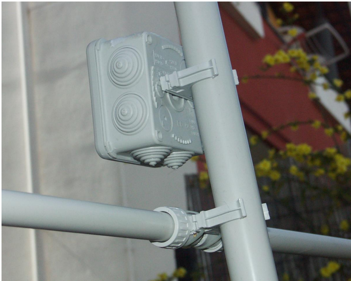
Foto 14 – Vista punto di alimentazione Square Loop, vista posteriore
